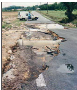
Figure 1. Ici, le réseau de collecte a résisté aux mouvements de sols
