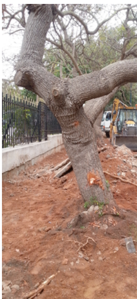
Figure 1. Travaux de voirie sans protection des arbres de Jacaranda mimosifolia de la rue Ibn Hajar (janvier 2019)
